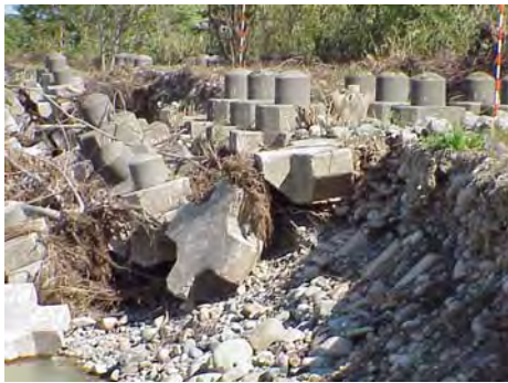
図 5-10 洗掘による被害
