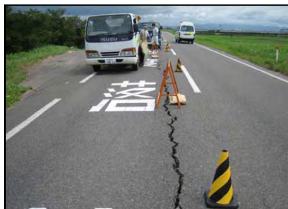
図 5-16 地震による堤防上面の亀裂
